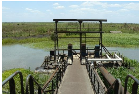
Figura 54 – Captação de Água para a Indústria, rio Zambeze
